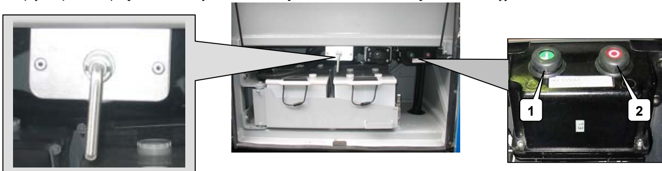
Rys. 15.13. Komora akumulatorów (PNEUBOX): 1 – przycisk awaryjnego wyłącznika zasilania, 2 - przycisk awaryjnego wyłącznika zasilania, 3 – wyłącznik masy
